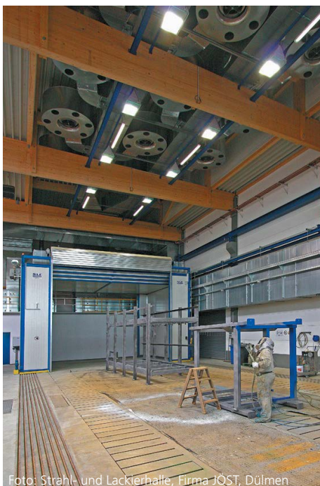
Foto: Strahl- und Lackierhalle, Firma JÖST, Dülmen
